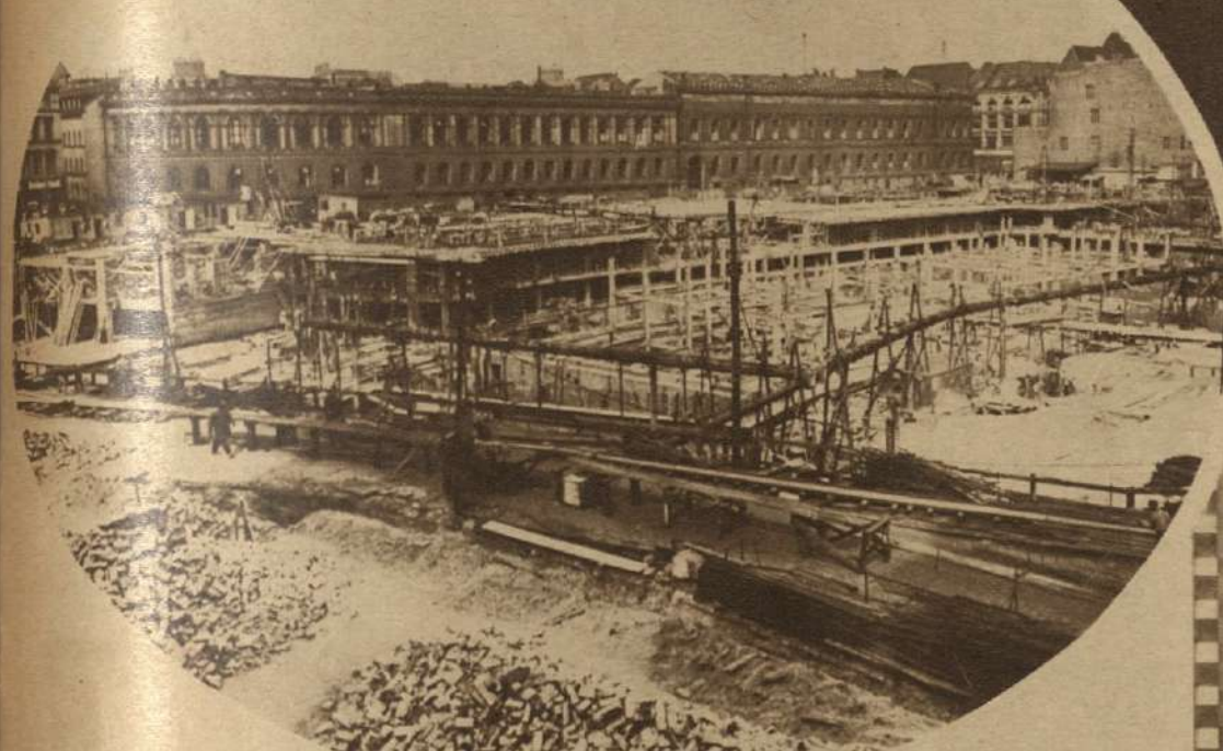
Panorama del nuevo edificio del Reichbank de Berlin, en construcción. El banco de estado de Alemania, que actualmente ocupa el venerable edificio que se ve al fondo pronto tendrá a su disposición un verdadero palacio moderno.
